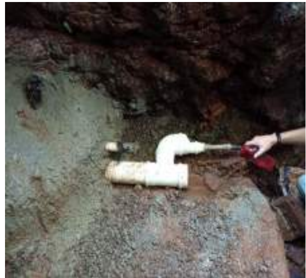
Figura 3: Nascente depois de protegida com o Bico de Pato instalado.
