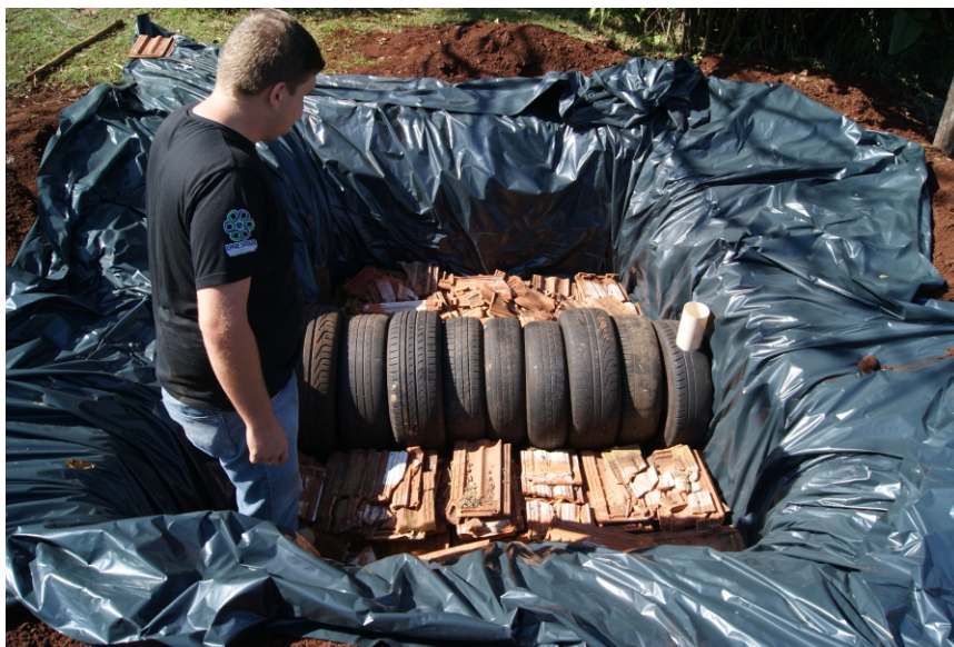
Figura 8 – Preenchimento com entulhos da construção civil
