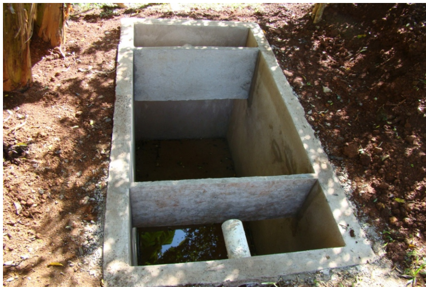
Figura 4: Fossa séptica construída em alvenaria ABNT NBR 7229
