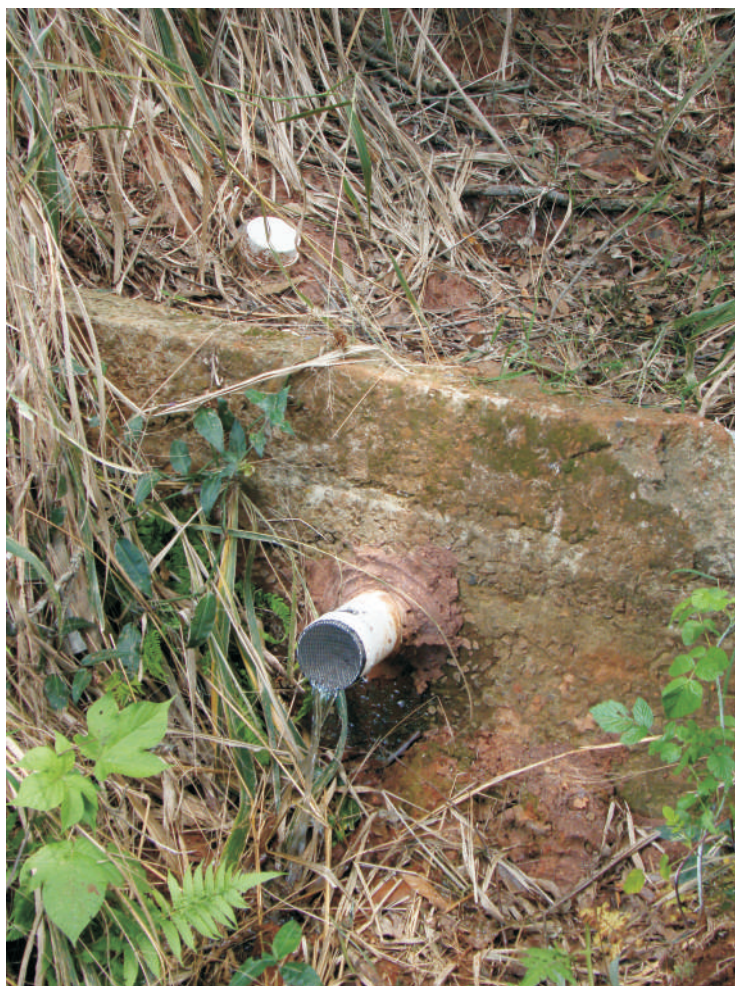
Figura 23 - Uso do sombrite na tubulação extravasora (Ladrão).
