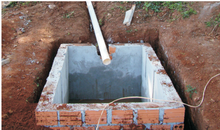
Figura 8 - Caixa da lavanderia.
